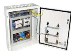
Системи автоматизації, стабілізатори, компенсатори
